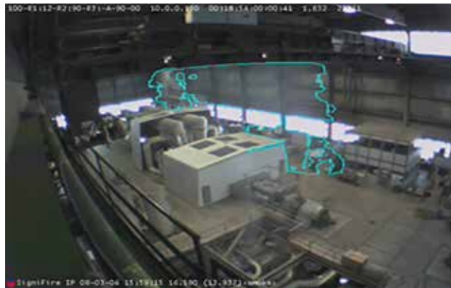
写真1. SigniFireが煙を感知した様子。 煙の範囲が青い枠で囲まれます。(発電タービン室に設置)
